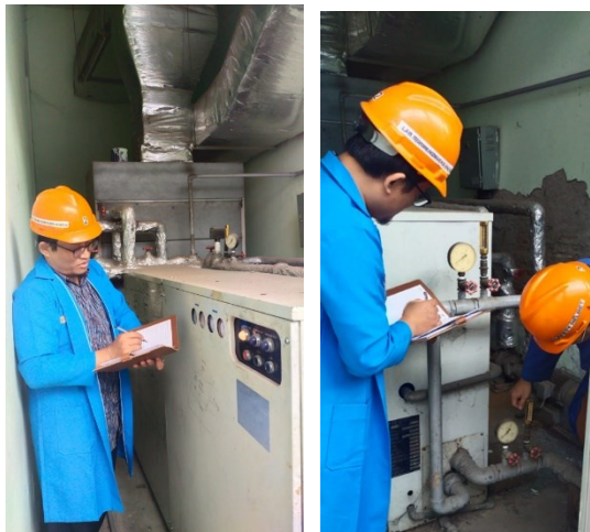
Melakukan Pengukuran Pada Panel Sistem Chiller Lab Konversi Energi
